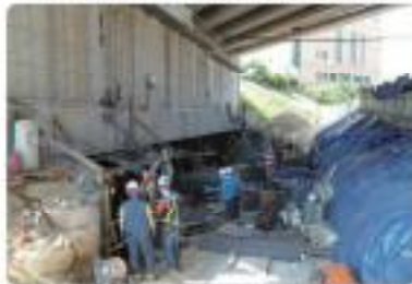
북신 건물 교량 해부보강 중 LPG 폭발('16.6.1, 사망 4, 부상 10)
