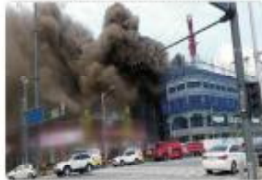
근린생활시설 신축공사 화재('16.9.10, 사망 4, 부상 2)
