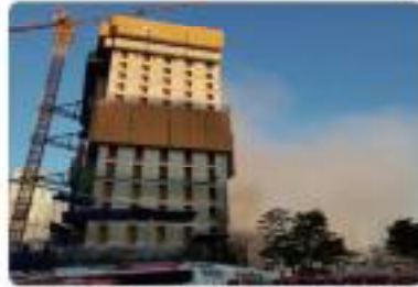
광교○○신축공사 중 화재('17.12.25, 사망 1, 부상 13)
