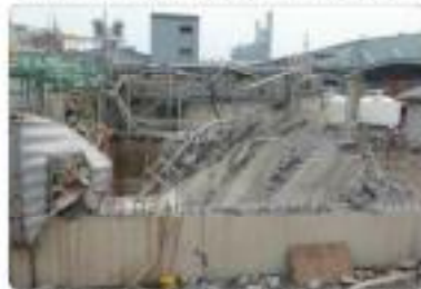
계수 환경 설계 구축공사 중 폭발('15.7.3, 사망 6, 부상 1)
